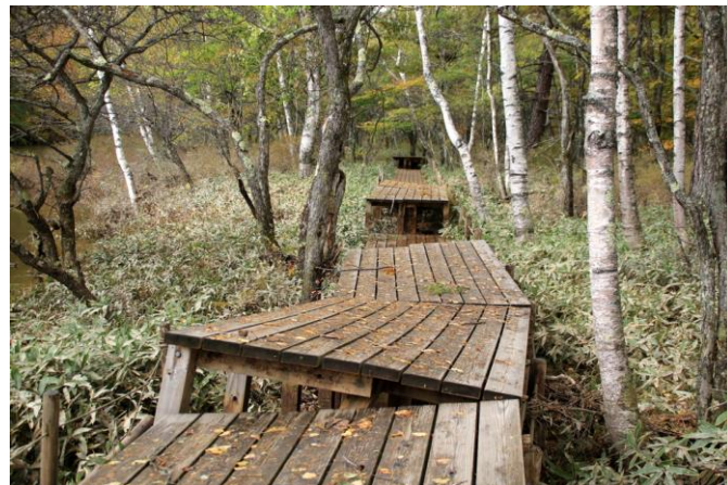
戦場ヶ原木道 破損状況例
